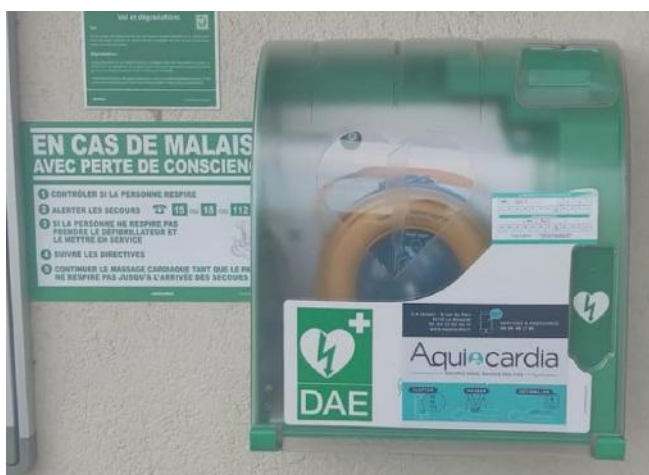
Un nouveau défibrillateur installé en accès libre à la salle polyvalente
